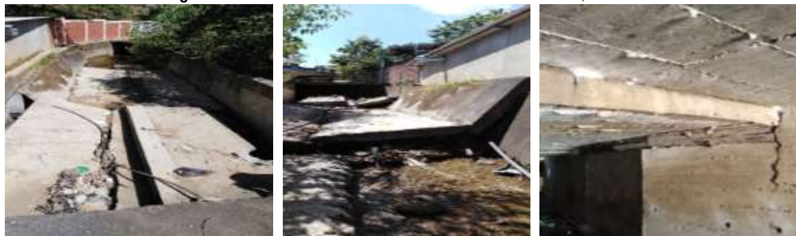
Figura 24. Estado del encauzamiento Quebrada San Francisco, ciudad de Pindal
